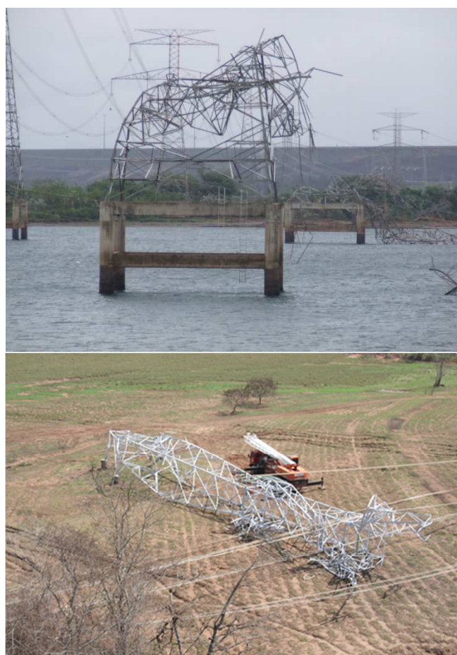
Figura 1 – Exemplos de torres da CTEEP danificadas devido a eventos de tempo severo.
