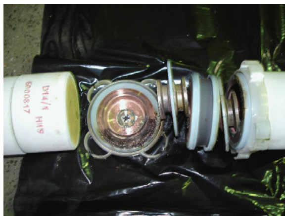
Figura 4. Sinais de ocorrência de descargas no centelhador.
