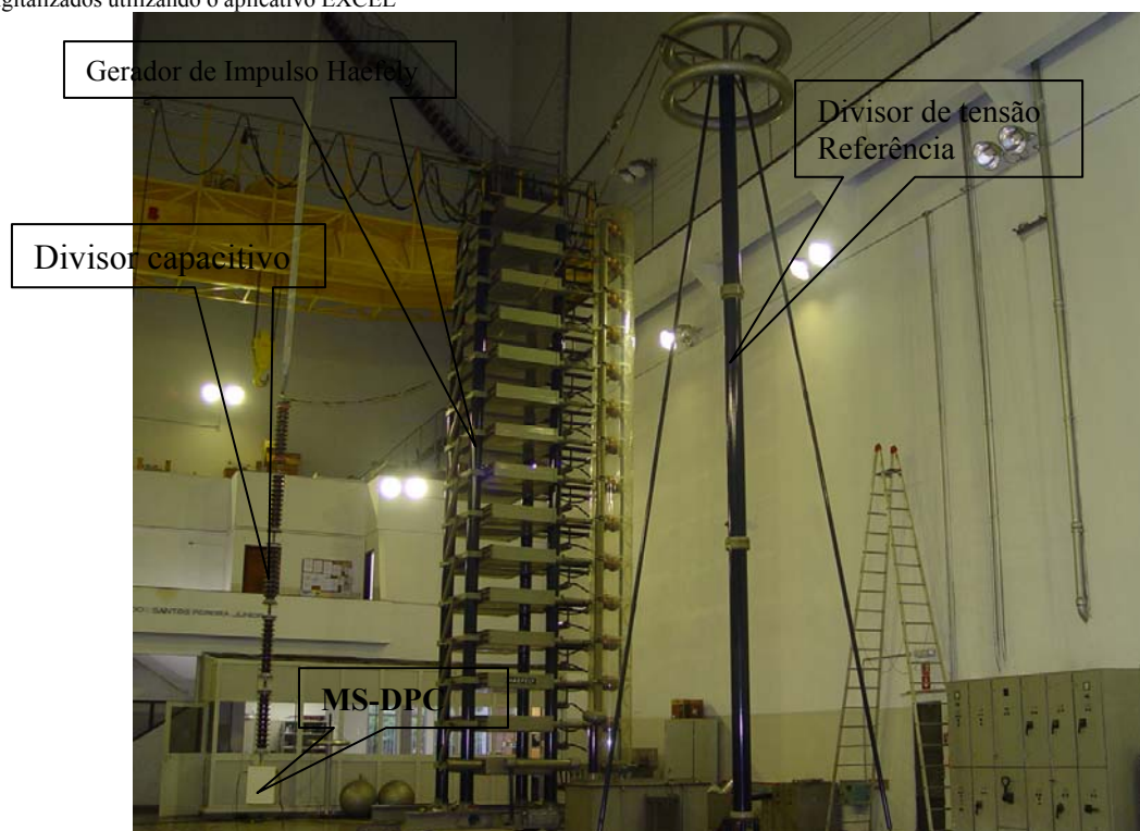
FIGURA 8 – Montagem utilizada nas calibrações, mostrando o MS-DPC suspenso ao módulo primário do Divisor Capacitivo, o gerador de impulsos, e o divisor de tensão Referência.
