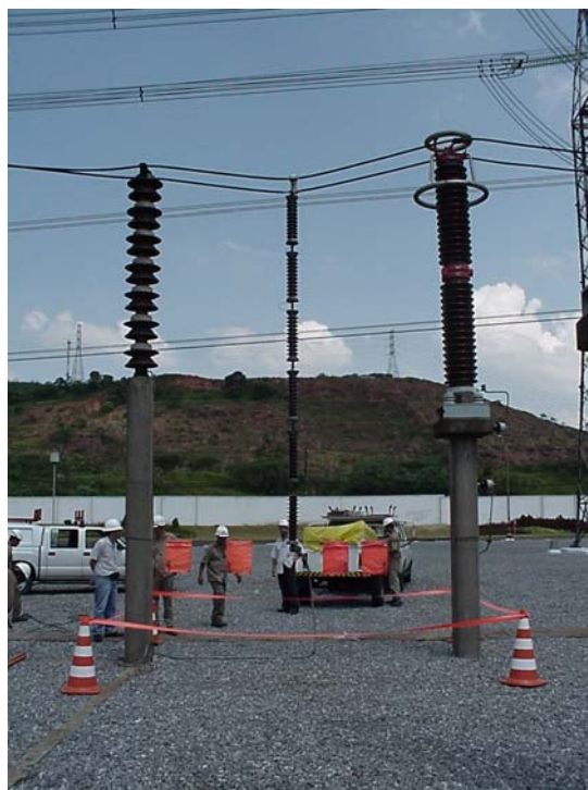
FIGURA 5– Módulo Primário do Divisor Capacitivo (na LTS Xavantes Bandeirantes 1 – fase branca). Exemplo de montagem.
