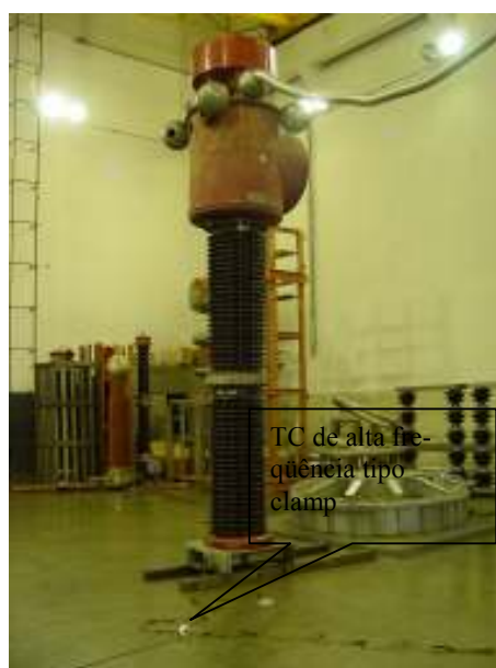
Figura 13 – Levantamento do espectro emitido por descargas parciais em TC 460kV – Medição com transformador de corrente de alta frequência tipo clamp instalado no condutor de aterramento. Durante os ensaios, foram identificadas as faixas de frequências que apresentam boa relação sinal-ruído para a medição de descargas parciais, nas condições do laboratório de Alta Tensão onde foram realizados os ensaios. na, correspondente ao ruído ambiental na faixa de frequências de 20MHz a 60MHz, na presença da fonte de tensão utilizada nos ensaios ligada e ajustada em 292kV, mas com o TC de 460kV desconnectado da fonte de ensaio.
