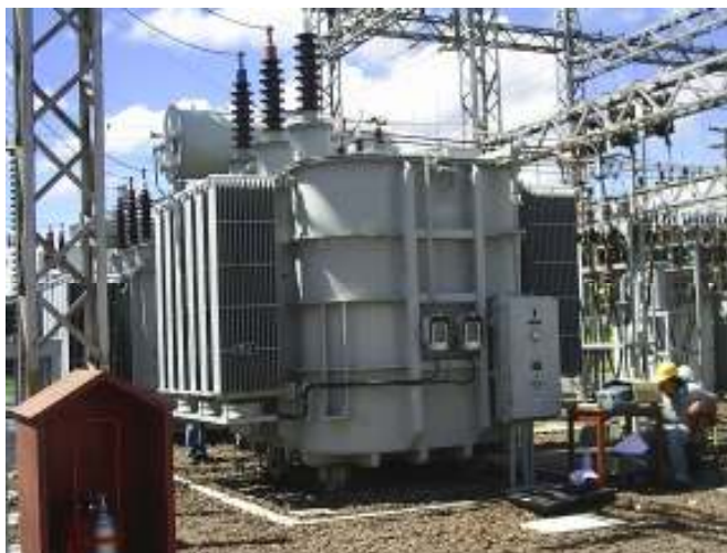
Figura 20 – Transformador TR-2 da SE (em segundo plano, à esquerda, Transformadores TR-1 e TR-3)
