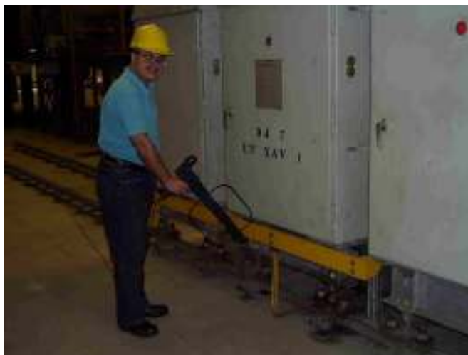
Figura 18 – SE Blindada do Sistema CTEEP – 362kV – medição no quadro de comando do disjuntor.
