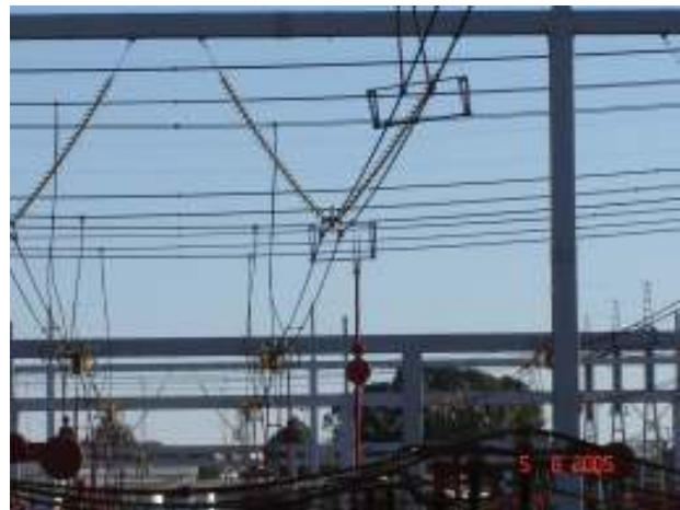
Figura 1- Configuração típica de barramentos com chaves seccionadoras da subestação da CTEEP-Bauru.
