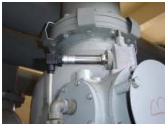
Figura 1. Detalhe do transmissor de pressão com interface de comunicação serial RS485 instalado.
