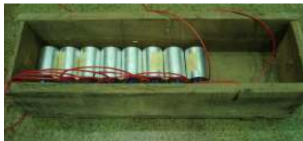
Figura 13 – Conjunto de capacitores utilizados para a compensação reativa, com tensão nominal 380VCA.
