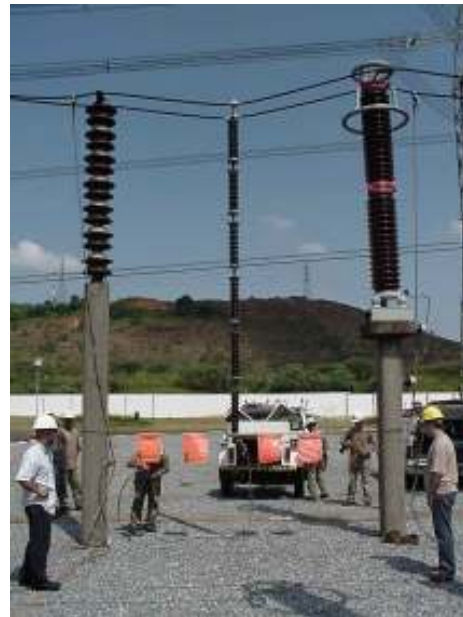
Figura 1 – Divisor de potencial capacitivo – medição em linha de transmissão de 345kv.
